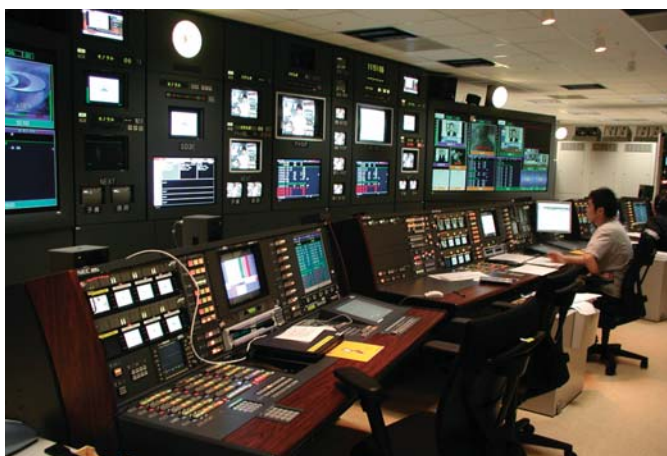
地上デジタル放送設備
