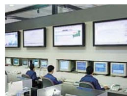
駅務監視システム
