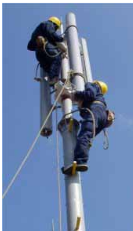
FRPアンテナ支持柱
