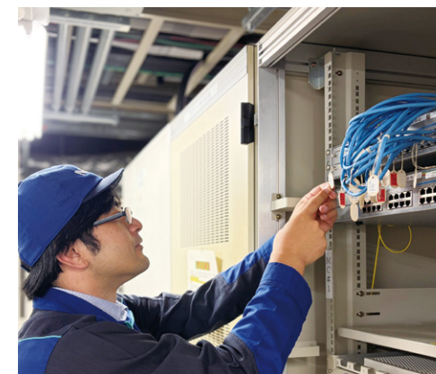
保守作業の様子(訓練時)
