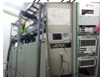
局舎電源 リハーシオン
