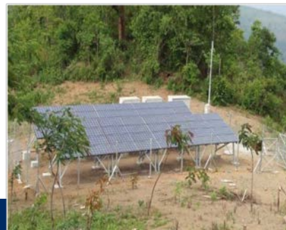
太陽光発電システム
