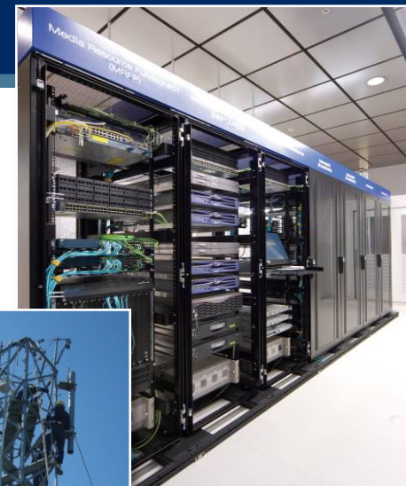
通信事業者向け 基幹ネットワーク
