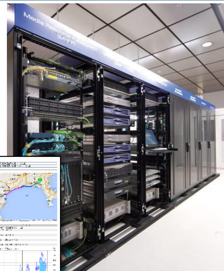
通信事業者向け 基幹ネットワーク
