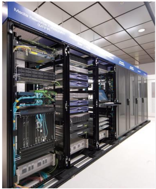
通信事業者向け 基幹ネットワーク
