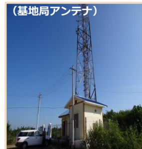
(基地局アンテナ)
