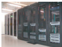
データセンター
